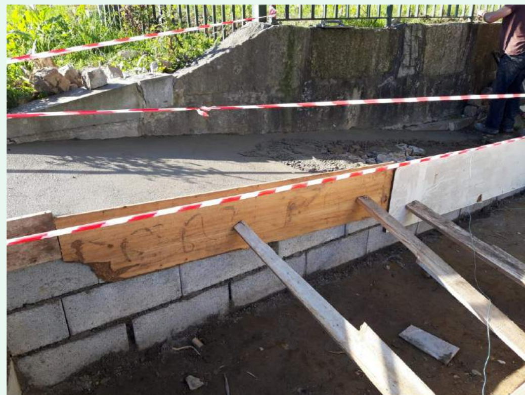
Trabalhos de alargamento do estacionamento para pessoas com mobilidade reduzida. Freguesia de Caldelas
